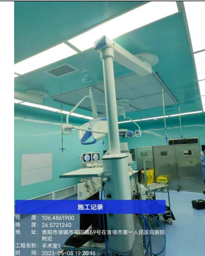
三楼手术间 01 通风管道、铅屏风
