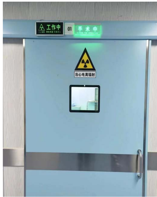
三楼手术间 01 防护门、电离辐射警告标识、工作状态指示灯（闭门状态）
