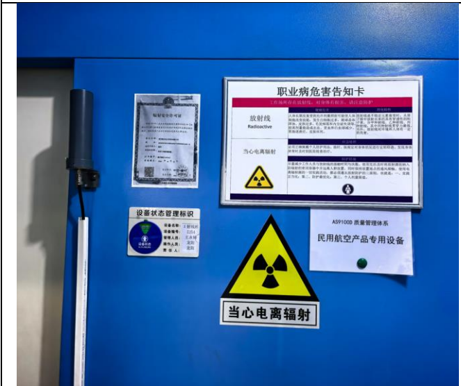
电离辐射警告标志及固定式辐射探测装置探头
