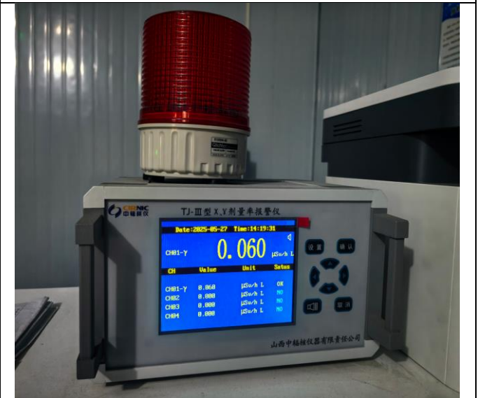
固定式辐射探测装置控制面板
